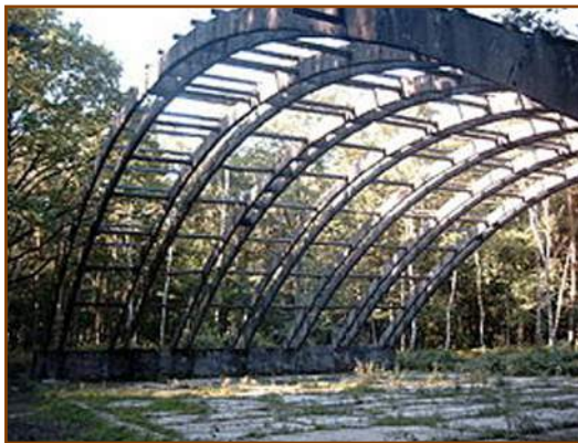
De overgebleven resten van een hangaar
